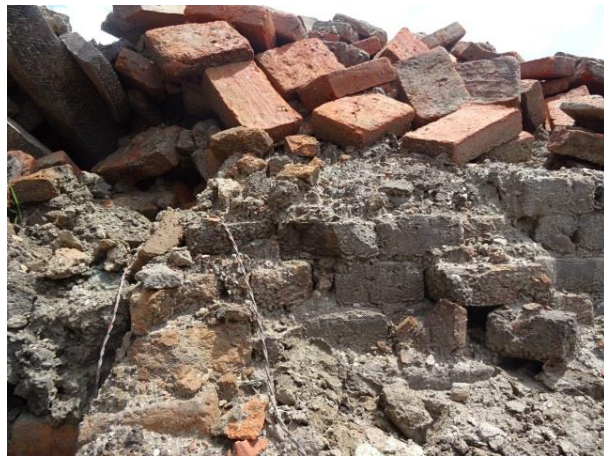
アドベ造倒壊例
